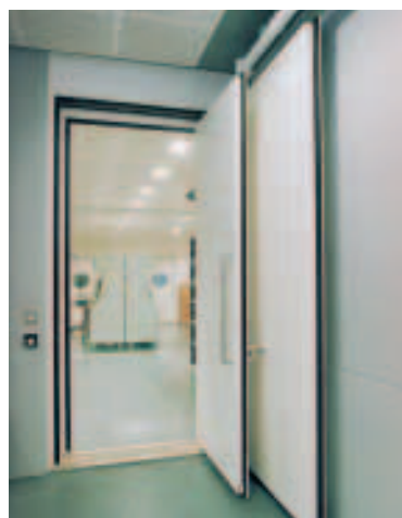
Acoustique avec sas double porte
